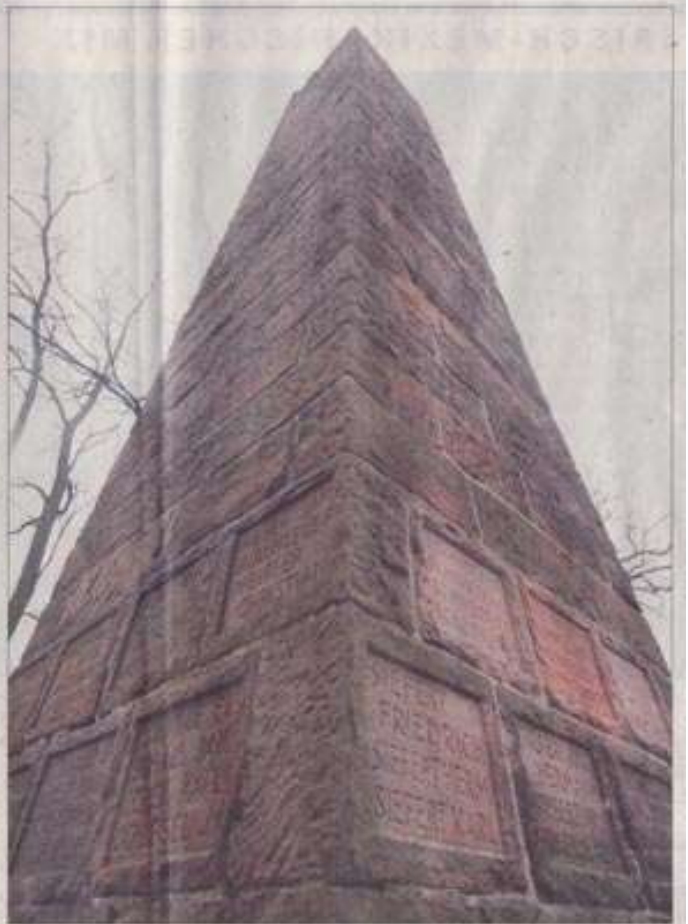
Kriegerdenkmal für die Gefallenen des Ersten Weltkriegs auf dem „Striegel“: Rund 720 Meter laufende Fugen sind zu erneuern. FOTO: MICHAEL BAMBERGER
